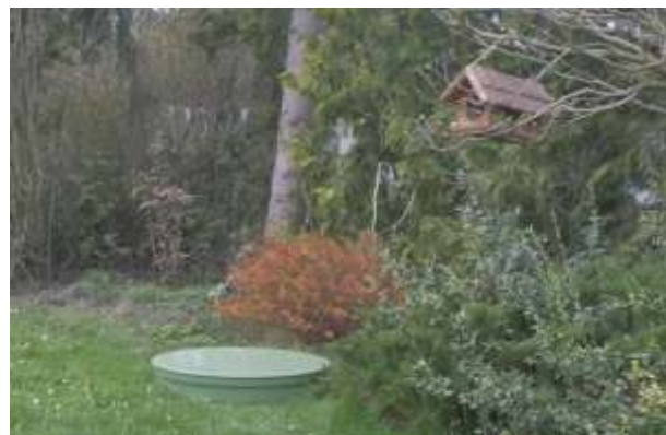
ČOV TOPAS R 5 po instalaci
